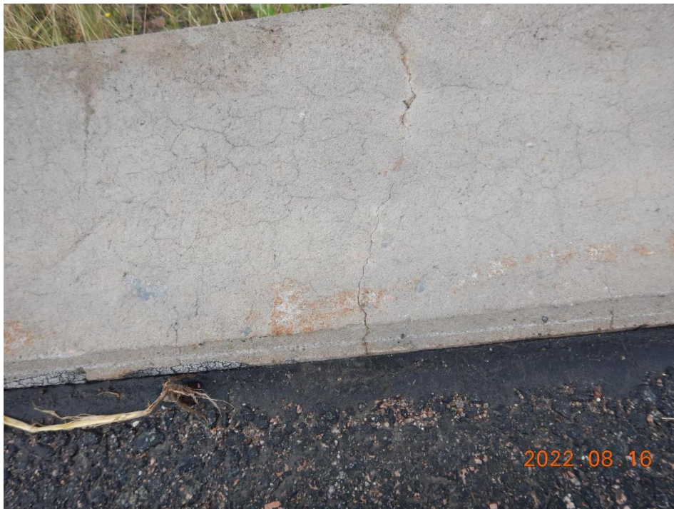
Figur 4 – Skadebild över spricka på kantbalk i armerad betong.
