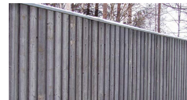
Figur 4.104. Bra exempel på beklädnad av bullerskyddsskärm med stående träplank och rak överkant.
