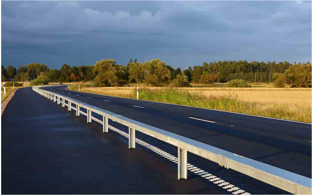
Foto 22. Mitträcke Birsta. Foto: Saferoad.
