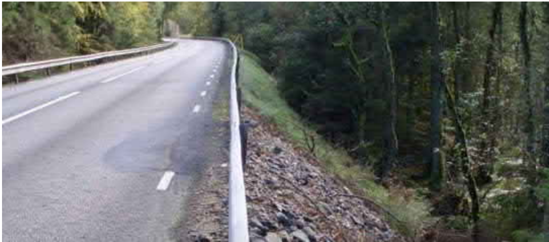
Figur 8. Lagad erosionsskada (Vägverket Konsult, 2007)
