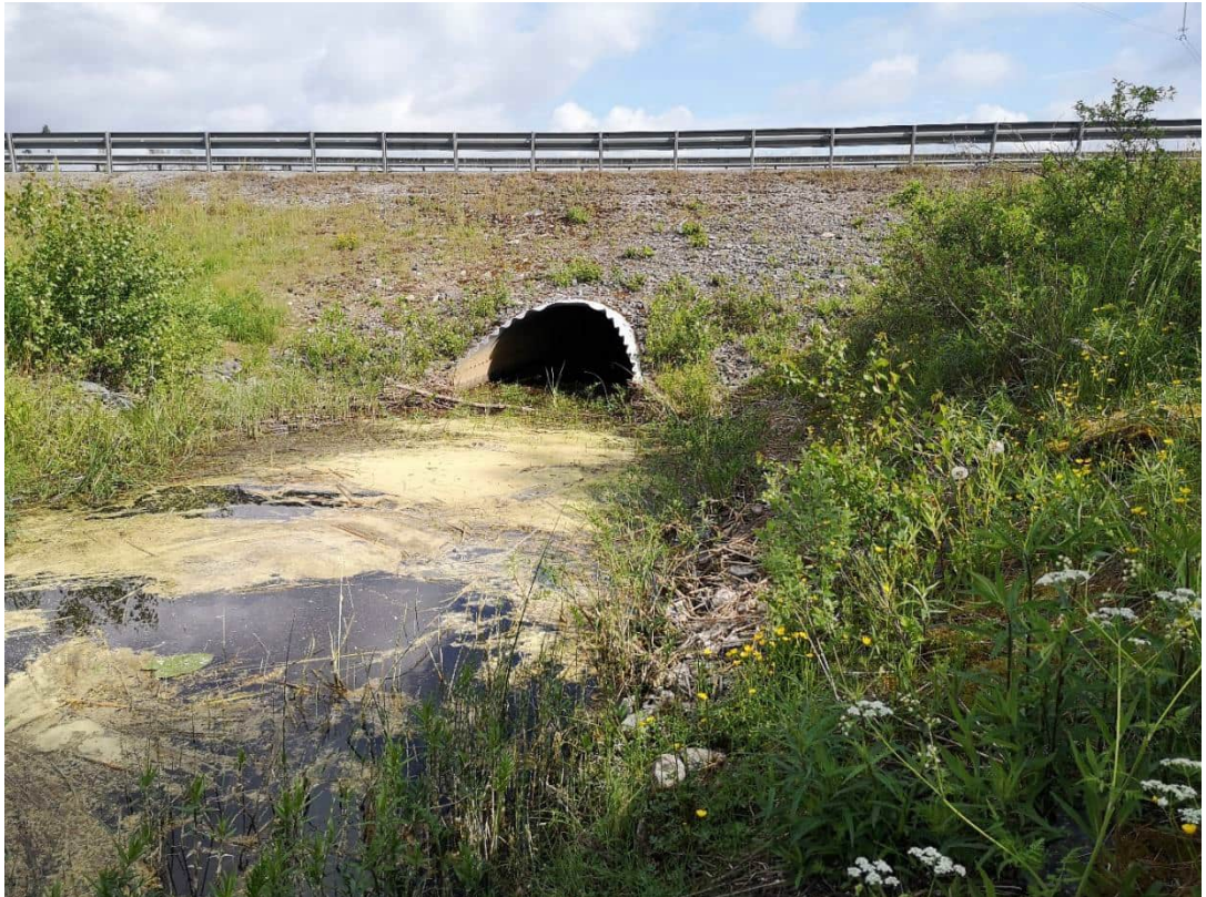
Figur 30. Trumma under väg 61 som förbinder Klacksjön och Åstjärnet.
