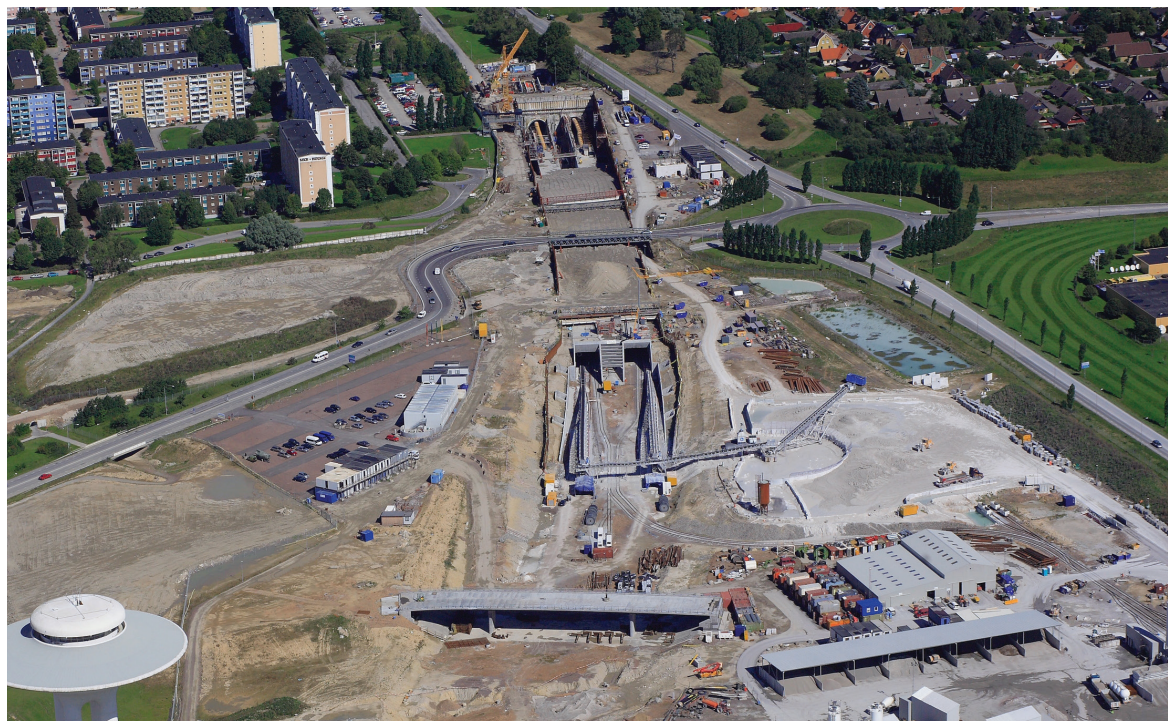
Figur 6.4 Exempel på schakt för tråg och betongtunnel i anslutning till tunnelpåslag för bergtunnel. Citytunneln vid Holma. Foto: Perry Nordeng 2007-09-04.
