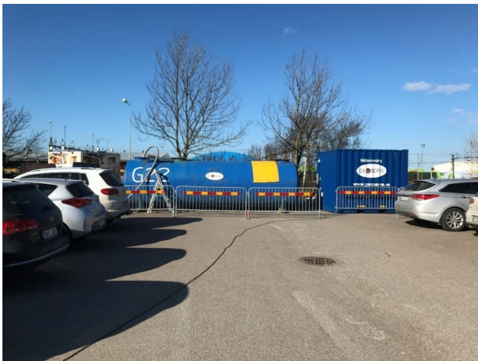
Bild 1. Reningsverk med tillhörande tank. Värmemattor höll på att läggas på toppen, då nattetemperaturen skulle krypa under -10^{\circ}\text{C} .
