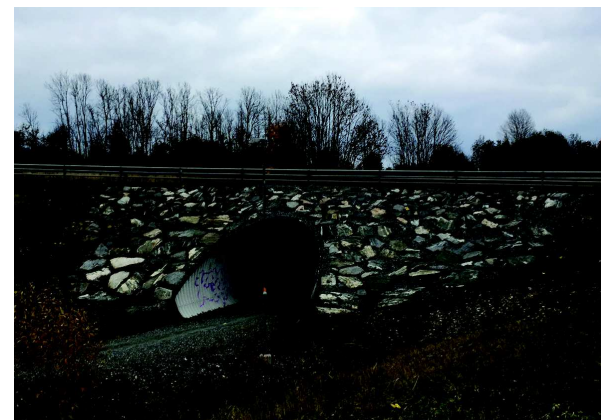
Exempel på rörbro med kantskoning och ljust målad insida. Stensättning kring mynningen med ordnad fältsten.
