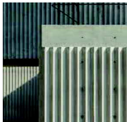
Exempel på ojämn betongyta med ett mönsterdjup som inte bjuder in till klotter.
