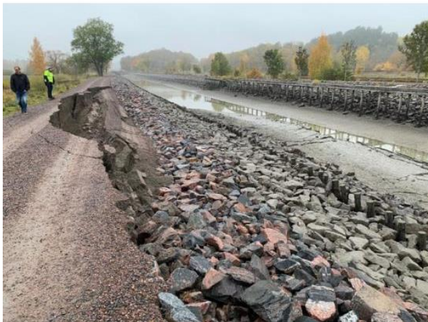
Figur 24 Skred i Göta kanal vid Klevbrinken. Oktober 2019.
