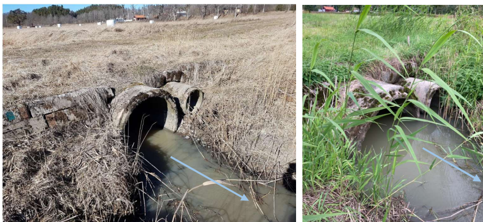
Figur 20. Foto på trummor under körväg, se Figur 18, där vattnets flödesriktning visas med blå pilar. Foto till vänster är taget 2017-03-23 (Okänd fotograf, Trafikverket, 2019). Foto till höger är taget 2021-08-26 (fotograf: Kristina Lundgren).
