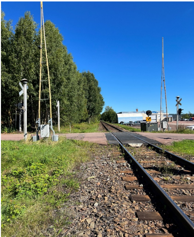
Figur 4. Vägskyddsanläggning med bommar och kur.
