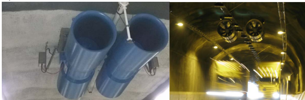
Figur 5.7 Impulsfläktar i tunneltak, Norra länken t.v. och Norrortsleden till höger.
