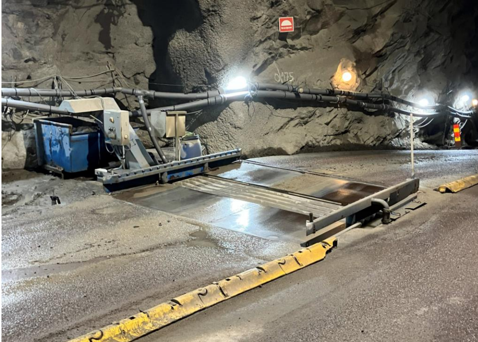
Figur 2 Exempel på en hjultvätt som finns installerad i en av Västlänkens servicetunnlar.
