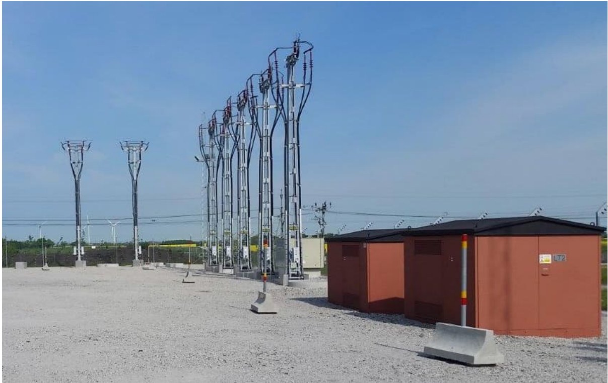
Figur 21. Referensbild på liknande anläggning med frånskiljarstolpar och transformatorer. Bild: Trafikverket.
