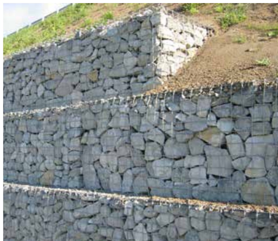
Figur 5.2.15 Exempel på gabionmur.
