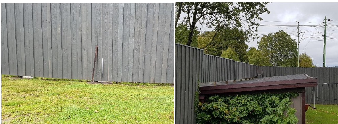
Figur 12. Befintlig bullerskärm vid fastighet Hoberg 6:12.
