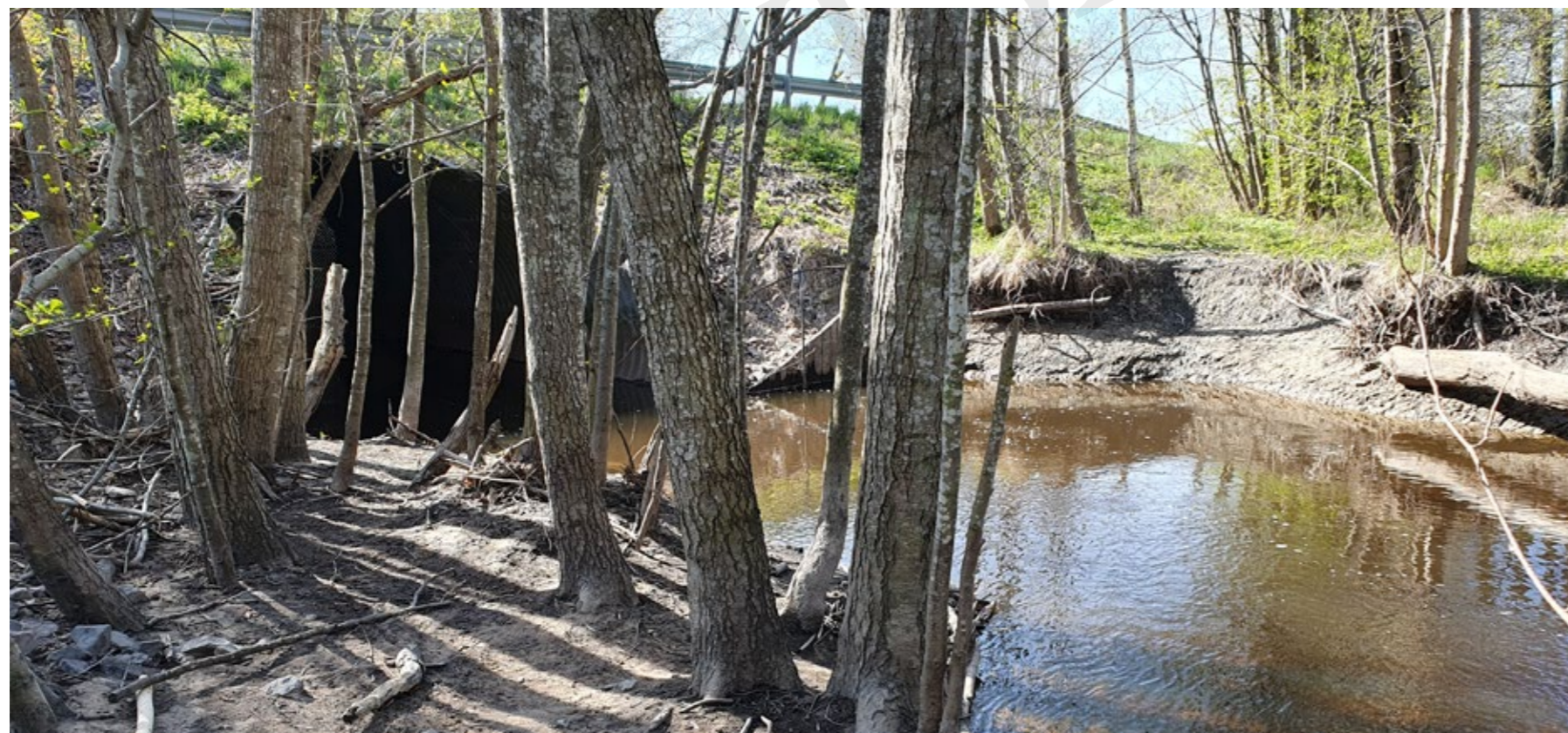
Figur 100. Erosionspåverkade slänter vid Pjältåns passage av Loddbyvägen.
