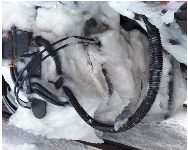
Foto: Kraftigt nedisad bromsutrustning på fordon litt X60
