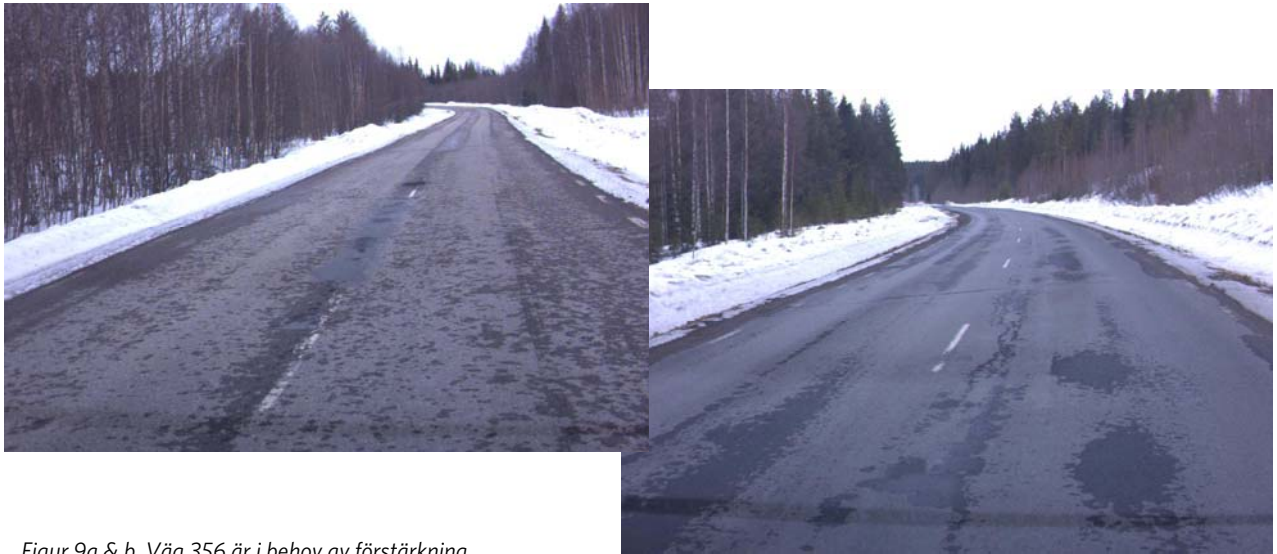
Figur 9a & b. Väg 356 är i behov av förstärkning.
