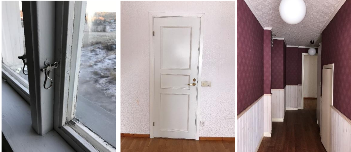
Fönster med kopplade bågar, troligtvis från 1950/60-talet. Modern dörr och korridor på nedre plan.
