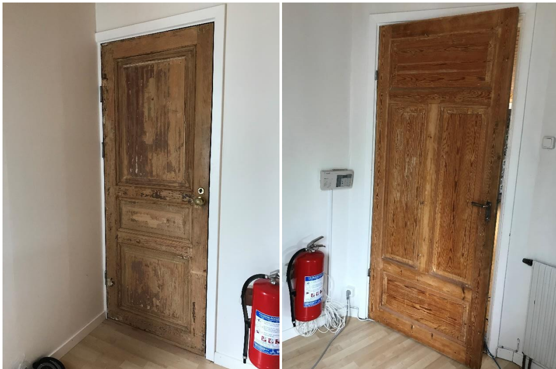
Den vänstra dörren har en äldre spegelindelning och gångjärn från mitten av 1800-talet.
