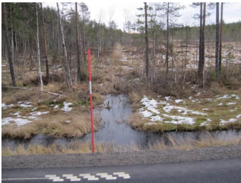
Figur 5. Vy från väg sydost på det högra utloppsdiket. Bild tagen december 2017 (Sweco, 2017).
