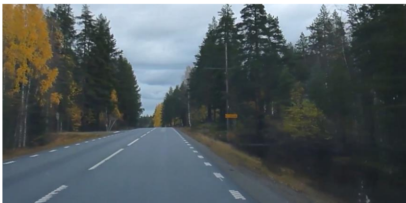
Figur 9. Vy nordost vid ca km 6/900. På höger sida av vägen kan stående vatten ses mot vägkroppen (Sweco, 2017).
