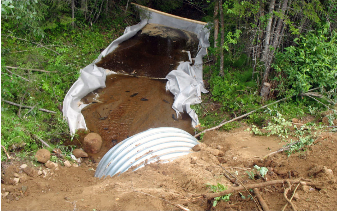
Figur 12. Exempel där geotextil lagts ut för att samla upp sediment vid anläggande av trumma. Källa (Trafikverket 2014)
