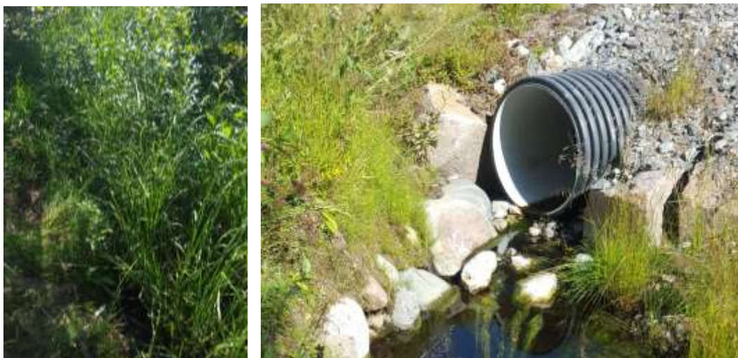
Figur 16 och 17 visar dikets utseende nedströms trumman under väg E 10. Diket är helt igenväxt och vattenflödet genom trumman nästan obefintligt.
