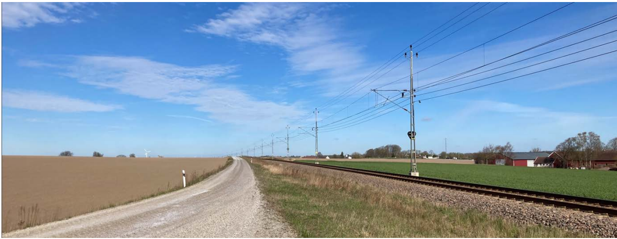
Figur 22. Bildexempel från annan järnvägssträcka som elektrifierats. Vy mot bandel i öppet landskap. Kontaktledningsanläggningen förstärker vägens linjeföring.
