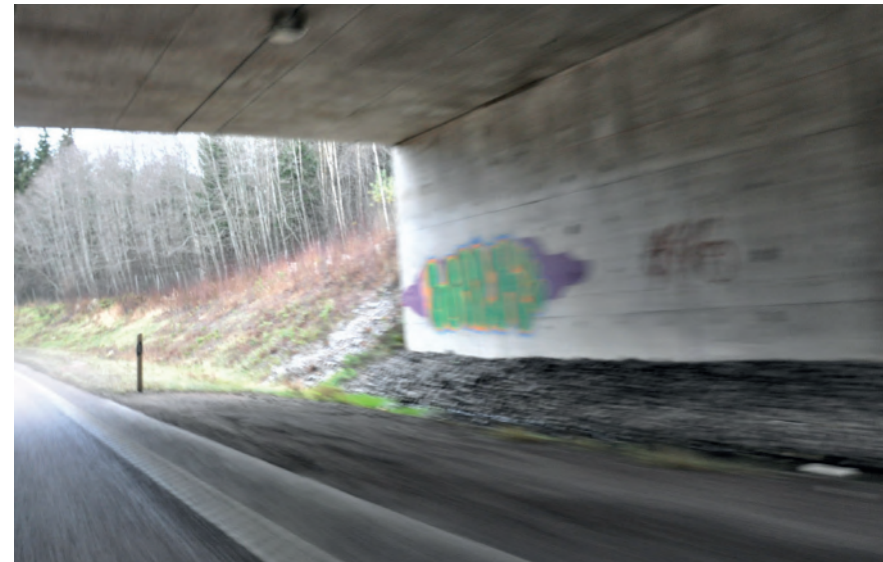
Figur 20. Befintlig bro. Kross täcker idag slänter och brokoner i anslutning till bron. Klottet förekommer på de släta betongytorna. Foto: Johanna Eriksson
