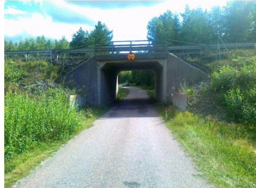
Figur 16: Befintlig vägport där både större och mindre däggdjur kan passera under vägen.
