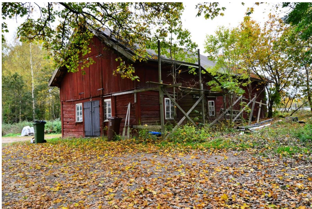
Byggnad som kommer att behöva rivas när ny väg byggs, Hallstahammar Berga 4:11
