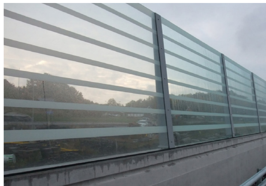
Figur 127. Referensbild; Exempel på liggande påflygningskydd.
