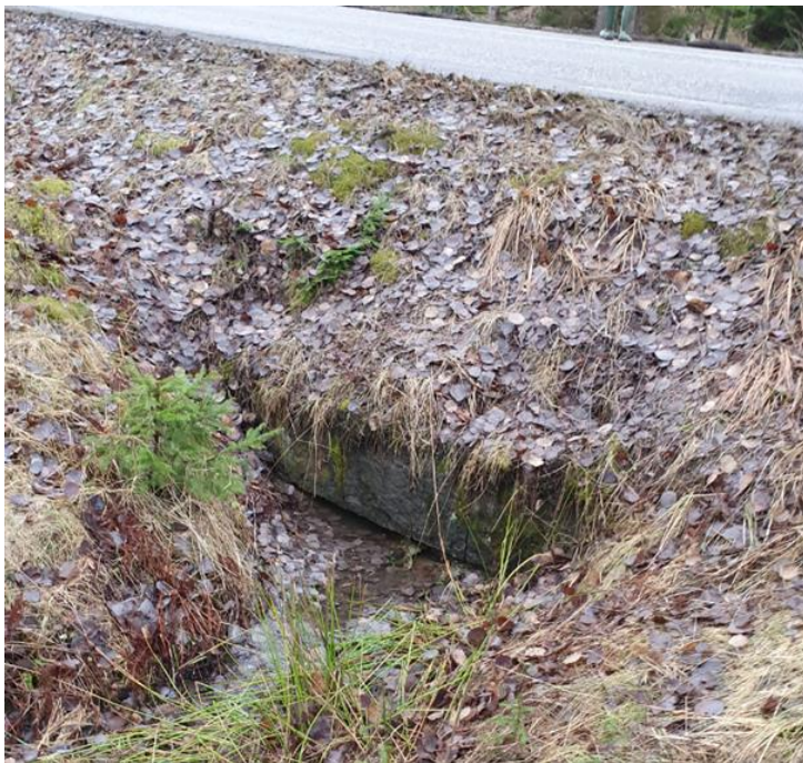
Figur 4.5.8:2 Befintlig trumma, igensatt.
