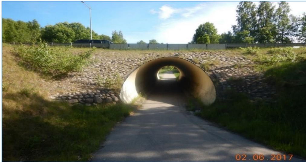
Figur 20. Bro över gång- och cykelväg vid Hasslerör (Trafikverkets förvaltningssystem för byggnadsverk, BatMan).
