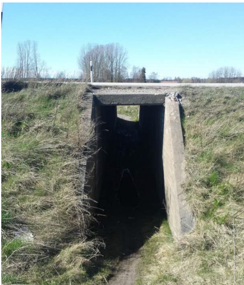
Figur 11. Koport vid Hasslerör, används av barn för att korsa E20 (Bild från Samrådshandling - Val av lokaliseringsalternativ).
