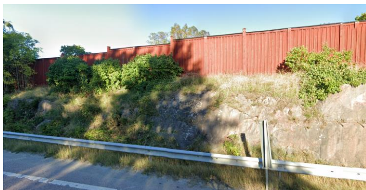
Figur 18. Befintlig bullerskyddsskärm vid km 12+200.
