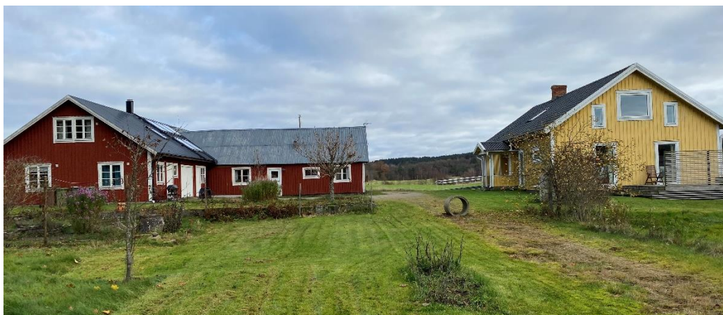
Figur 30. Flähult 1:4. Boningshuset, byggnad 2, har ett modern träräcke som syns till höger i bild och som föreslås ersättas med en skärm. Till vänster syns magasinet, byggnad 1, med de fönster som föreslås åtgärdas på plan 1 och 2.
