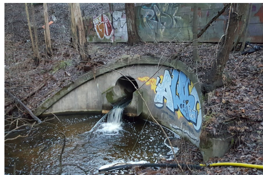
Figur 6.4.4. E4/E20 sett nedströms, vy från väster. Befintlig trumma med fritt fall utgör ett vandringshinder för vatten- och marklevande djur. Foto: Tyréns.
