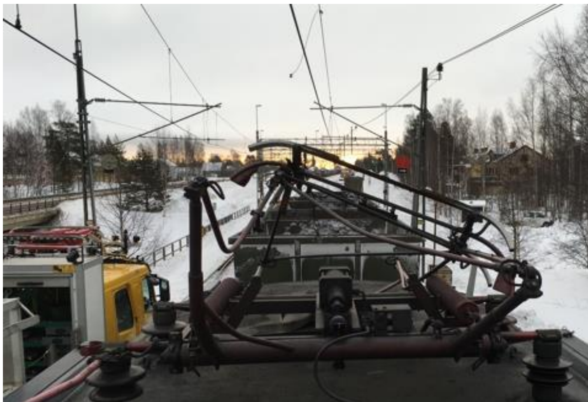
Bild 11. Skadad strömavtagare och kontaktledning på fordon i samband med färd in till område utan kontaktledning.
