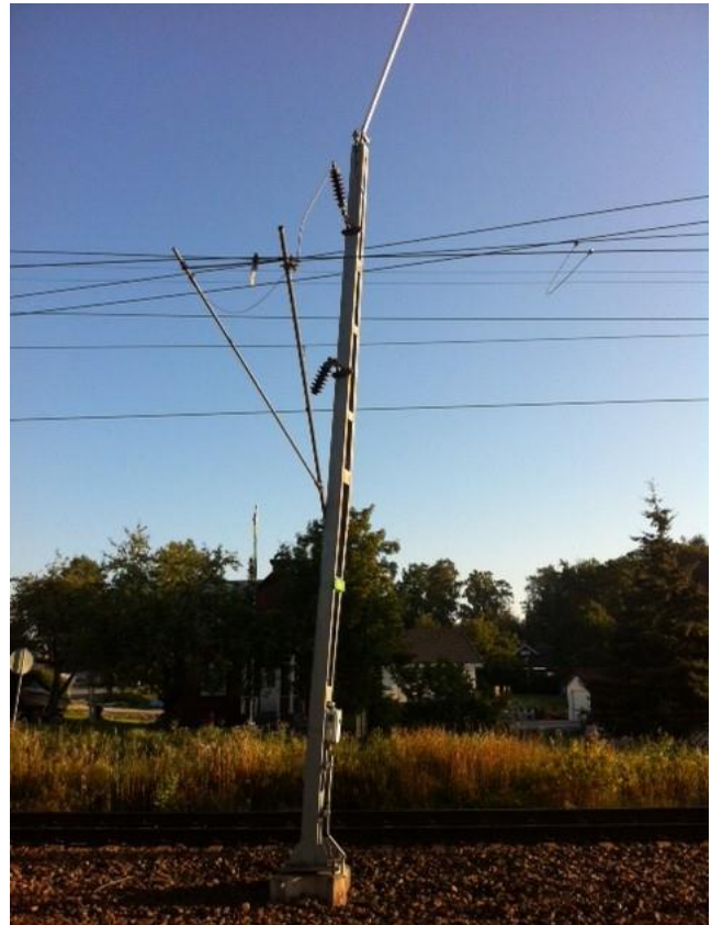
Bild 12. Skadad kontaktledningsstolpe till följd av utskjutande last på passerande fordon.
