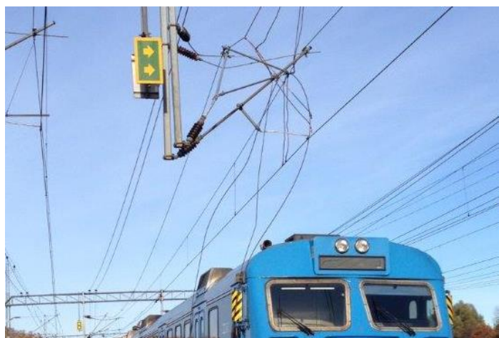
Bild 4. Kontaktledningshaveri i samband med stoppförbudszon.
