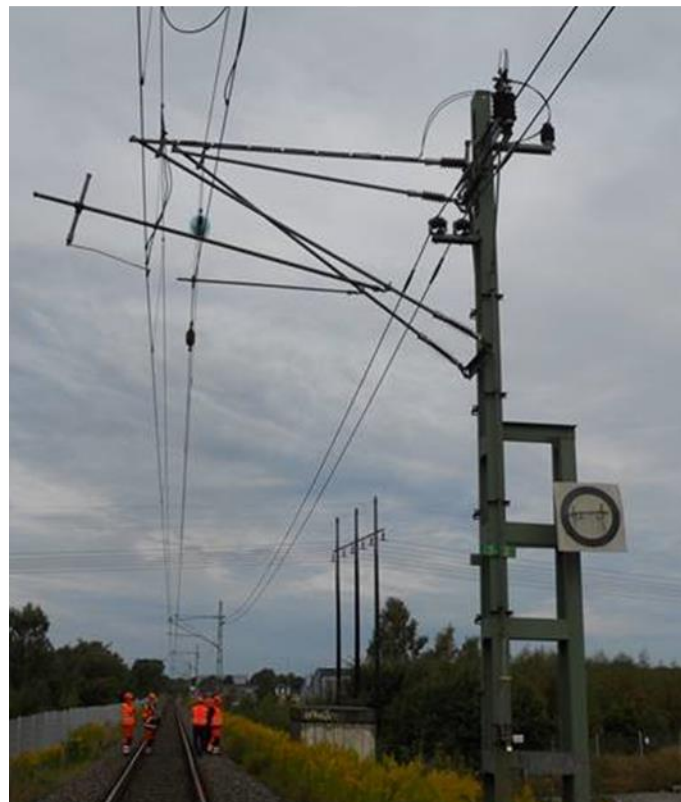
Bild 2. Reparation vid kontaktledningshaveri i samband med skyddssektion.
