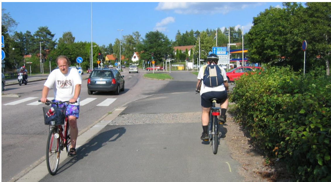
Figur 13. Avgrävd cykelväg som inte utmärkts och där återställning dröjt.
