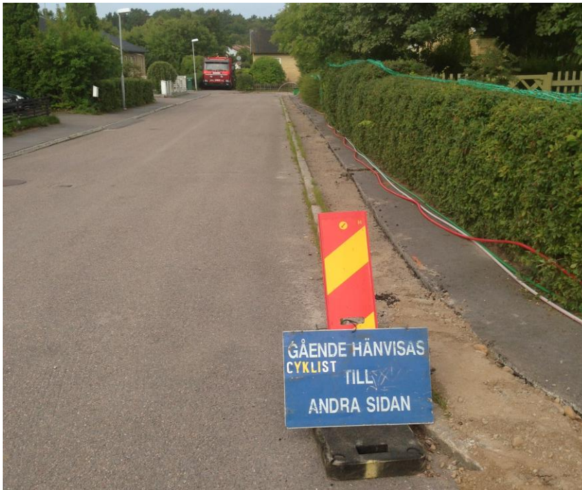
Figur 24. Utmärkning som på intet sätt vägleder cyklister förbi arbetsplatsen.
