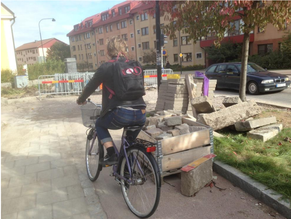
Figur 7. Omarkerad låda med byggmaterial placerad på en cykelbana i närheten av ett vägarbete. I dagsljus kan cyklister uppmärksamma lådan och hinna väja, men i mörker blir det mycket svårare, med risk för olycka som följd.
