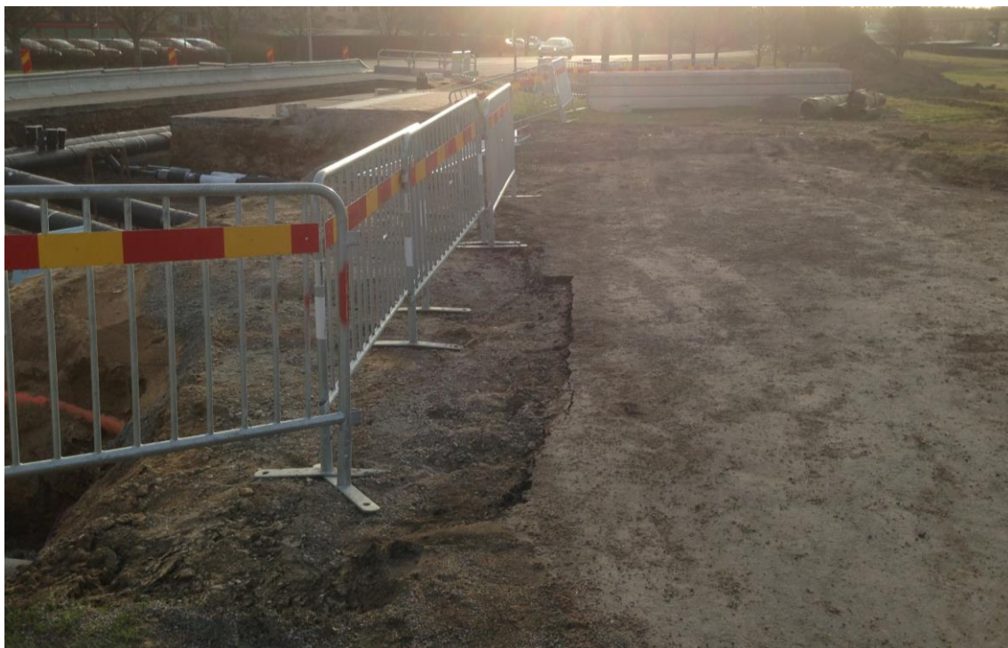
Figur 4. Grus och smuts på cykelväg från ett pågående vägarbete. Notera också att avspärrningen felaktigt placerats utanför vägkant och mycket nära schakten. Staketen är också instabila och hindrar inte en cyklist som kör in i staketet att ramla ner i det djupa schaktet. Längre fram har några av staketen fallit omkull (Figur 5).
