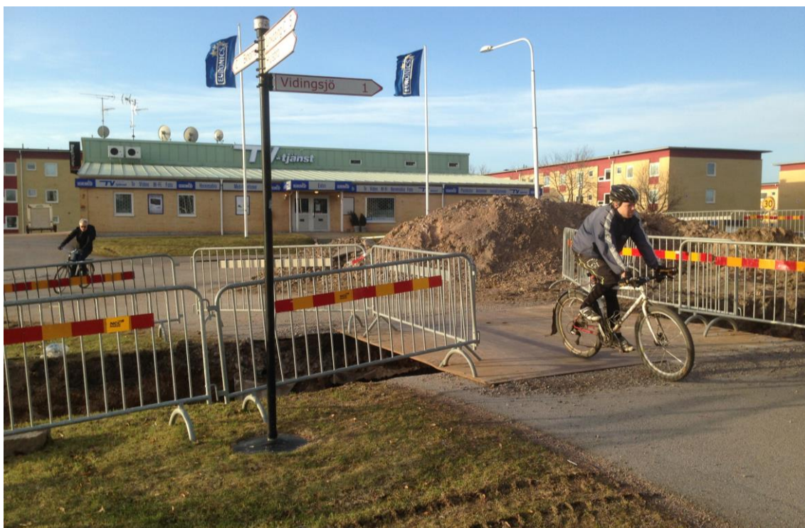
Figur 9. Körplåt lagd över ett schakt. I detta fall har den skarpa kanten "fasats av" med hjälp av grus.
