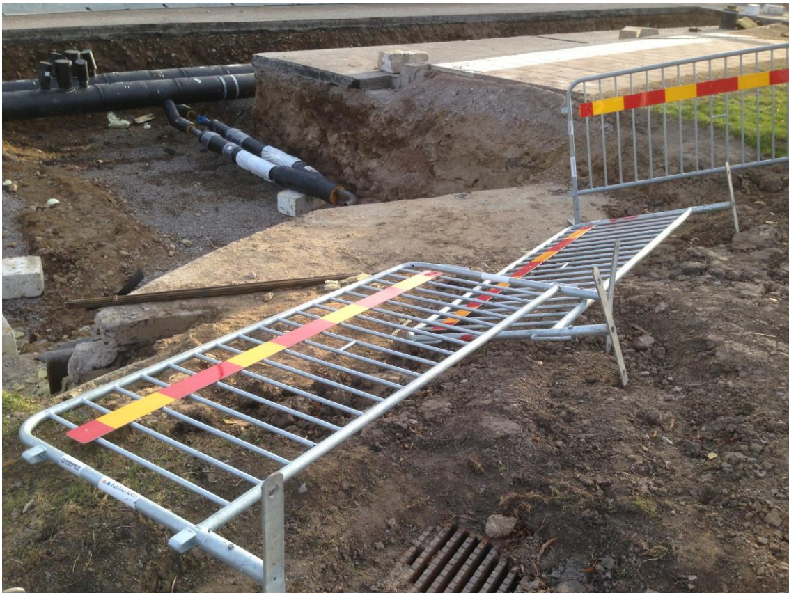
Figur 5. Omkullfallna avspärrningsstaket placerade farligt nära den djupa gropen.
