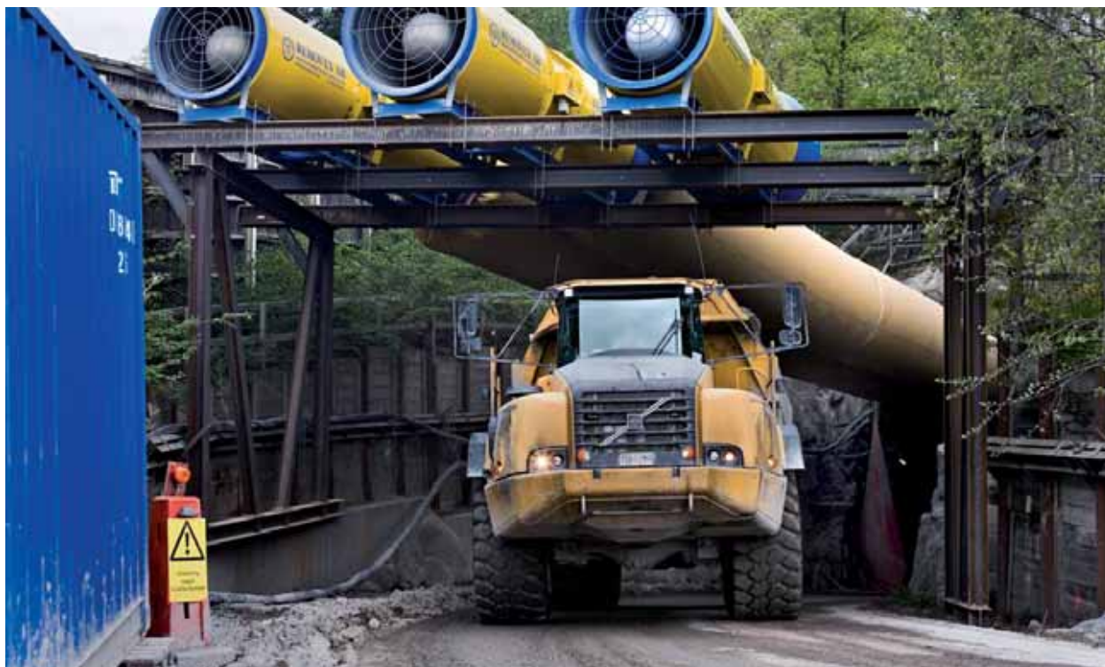
Figur 12.8. Fläktsystem för att ventilerar ut spränggaser från tunnlar.
