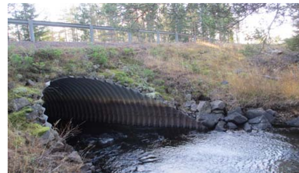
Bild 19. Rörtrumma med erosionsskydd av kross
