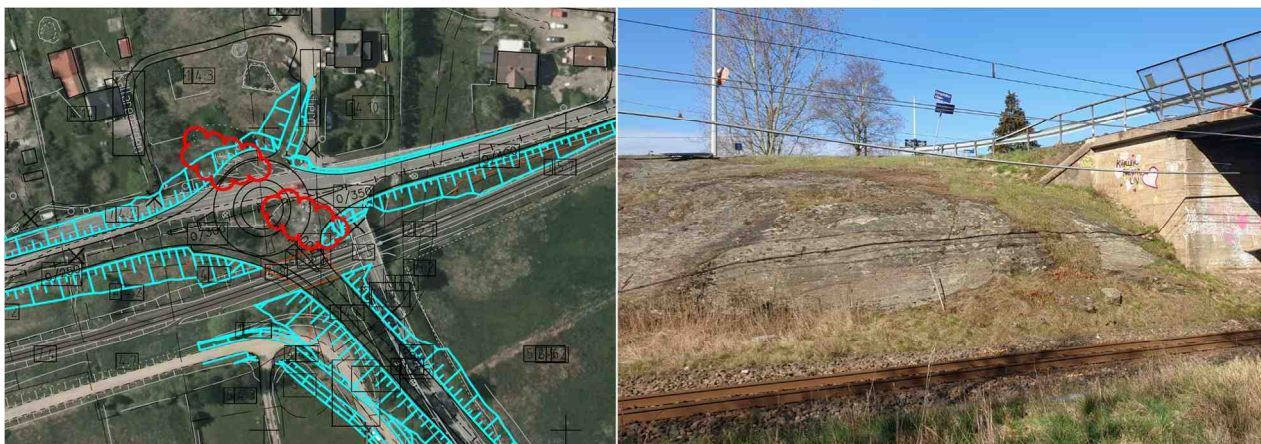
Figur 1. Vänster: Område med berg i dagen som besiktats visas med röda markeringar, norr är åt höger i figuren. Höger: Foto mot väster av besiktat område.
