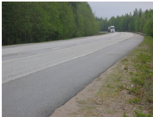
Tvärgående sprickor och spårbildning.
