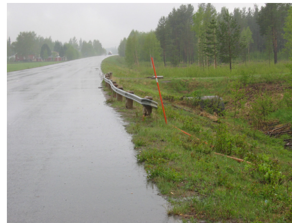
Undermålig standard på befintligt sidoräcke.
