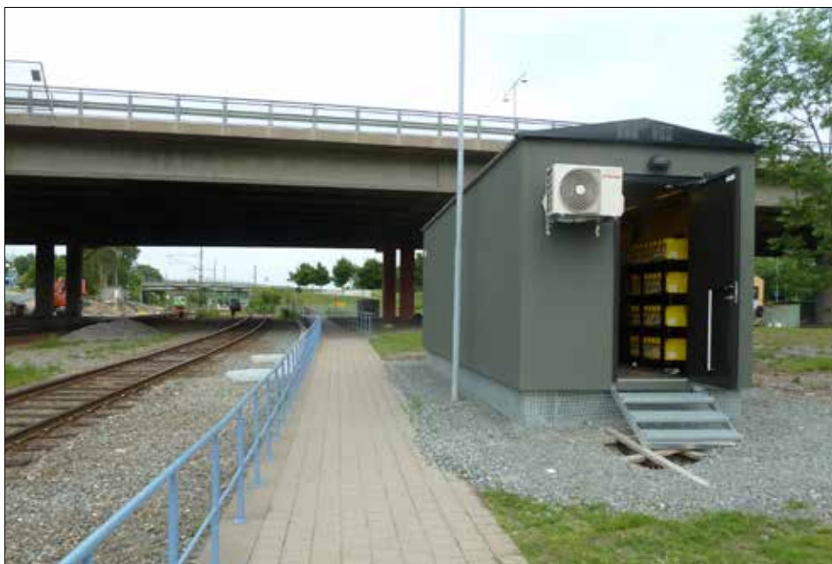
Figur 11.2:5 Exempel på signalkiosk
