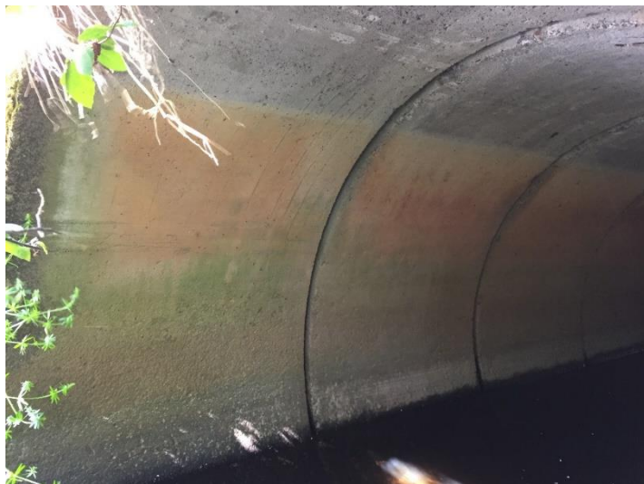
Figur 22. Missfärgning inne i trumma.
