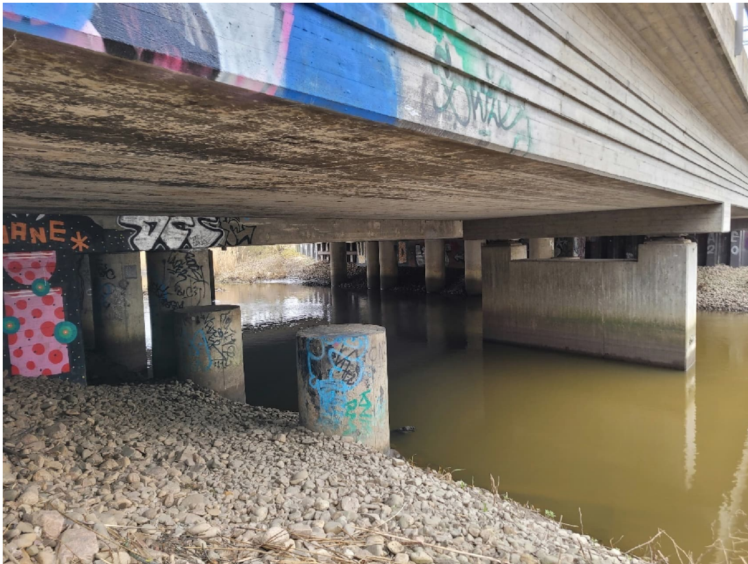
Figur 6. Befintlig bro med skivstödet mitt i Segeå. Vid utbyggnad 1984 byggdes ett stöd för en eventuell utbyggnad av passagen med en ny bro. De två runda pelarna närmast i bild användes inte när man 2004 utökade antalet broar. Man valde då istället att bygga skivstödet mitt i ån. Vy från norr. Foto: Tyréns AB 2022-03-17.
