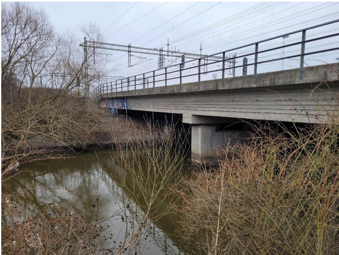
Figur 5. Befintlig bro med skivstöd mitt i Segeå. Vy från söder. Foto: Tyréns AB 2022-03-17.
