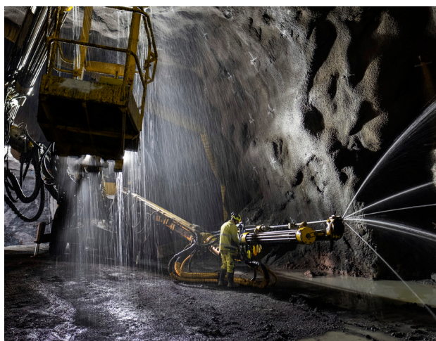
I den fortsatta tunneldrivningen, både norrut och söderut, kan vi komma att kombinera olika tekniker för berguttaget. Foto: Kasper Dudzik.
