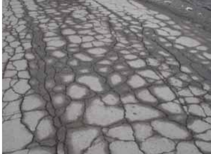
Krackelering är en typisk skada på en åldrad beläggning.
