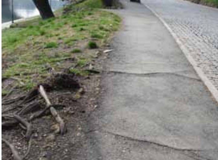
Gångväg skadad av trädrötter.
