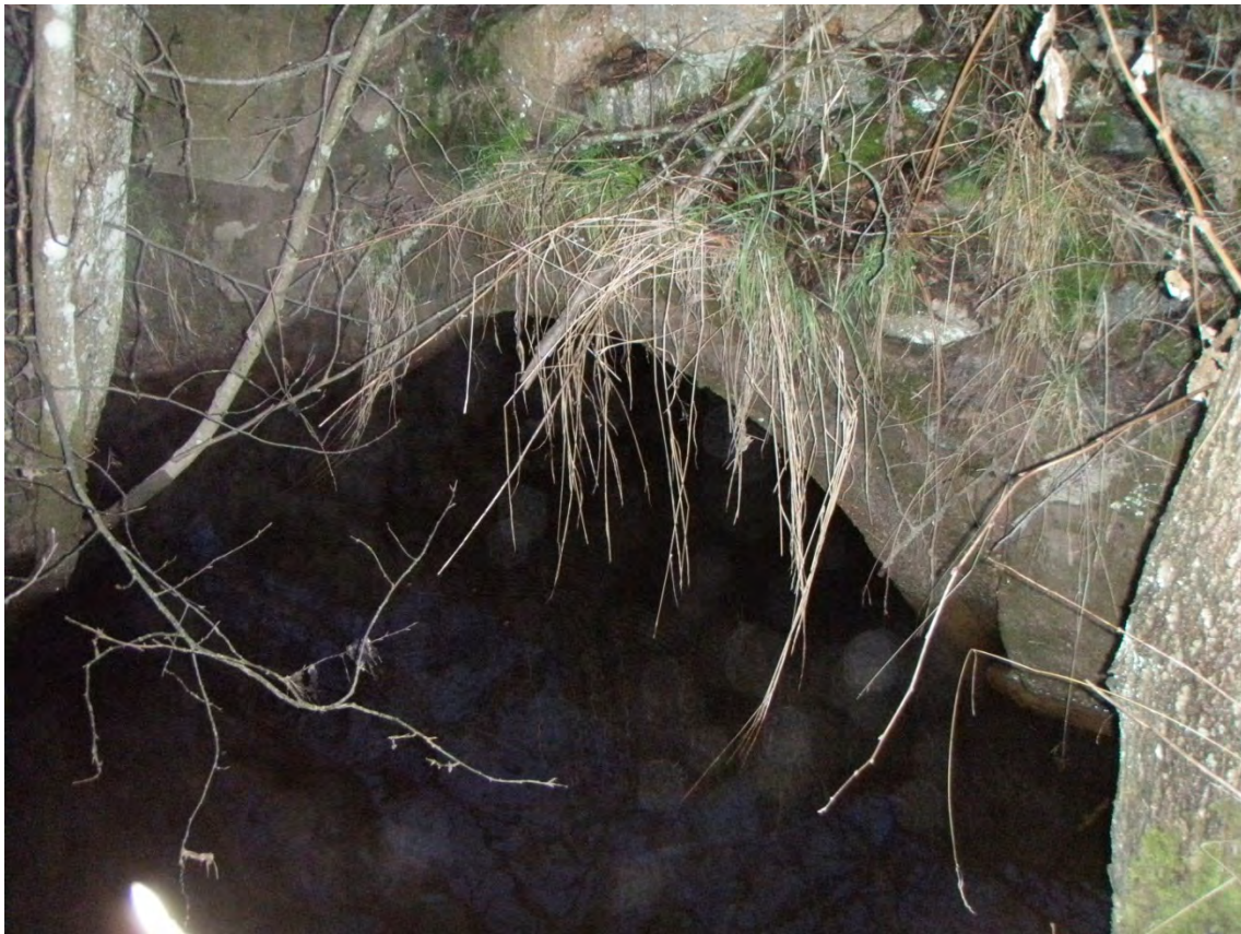
Bild 17. Delsträcka 4. Utloppet på trumman under väg till avfallsanläggning. Trumman ligger mycket lågt.
