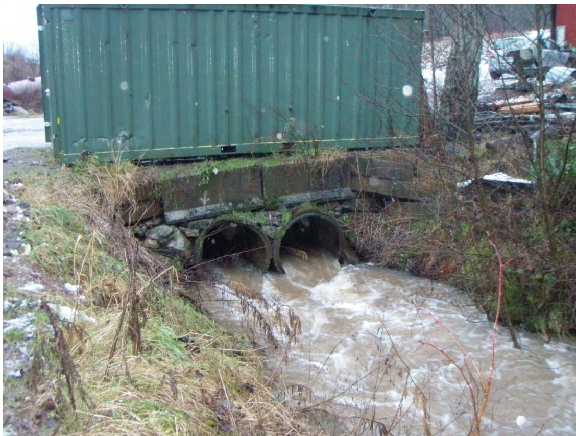
Bild 23. Delsträcka 9. Dubbeltrumman under lokalvägen utgör beroende på vattenföring ett vandringshinder för fisk.
