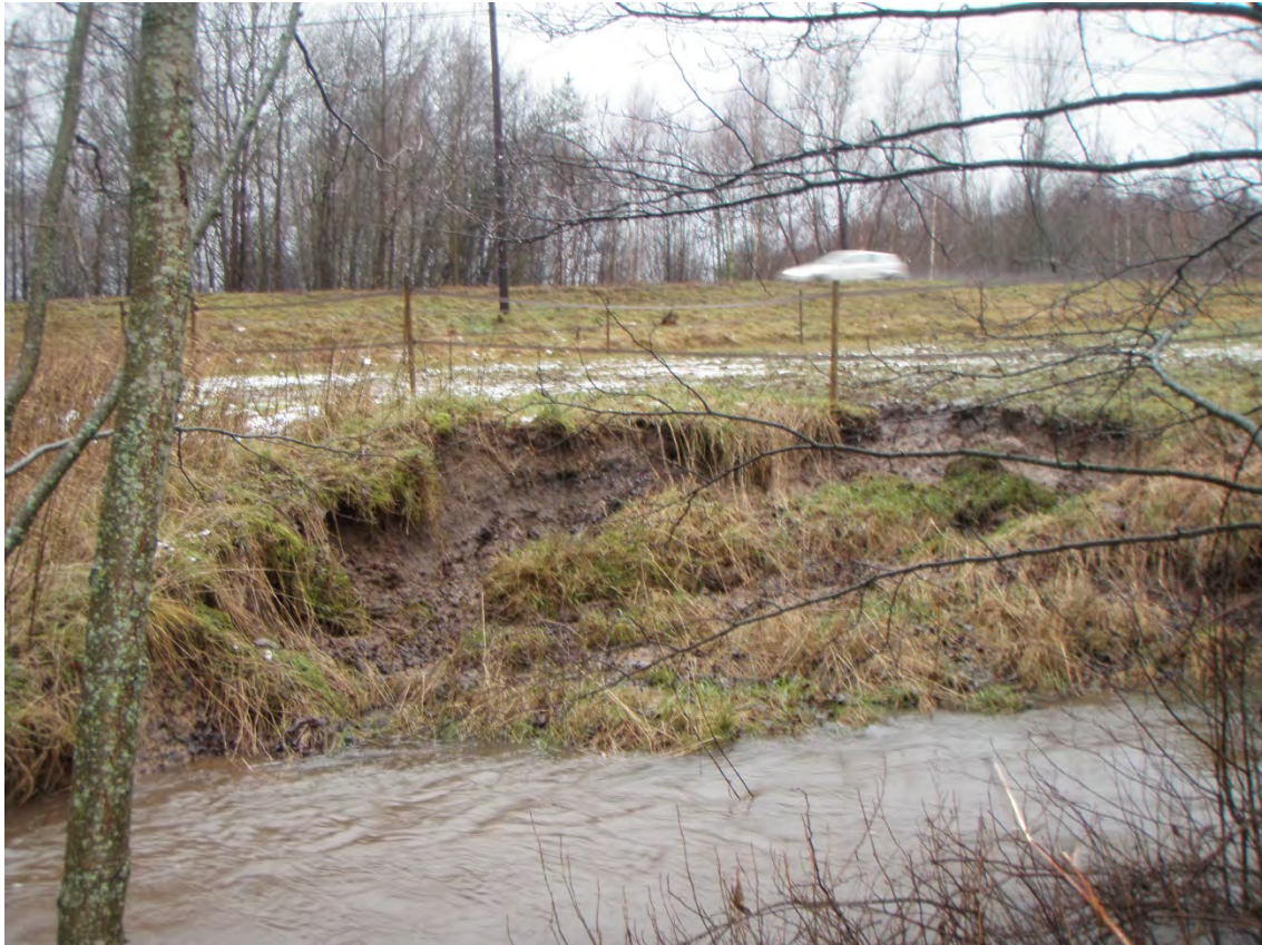
Bild 27. Delsträcka 12. På delsträckan finns flera mindre skred (befintlig väg E20 i bakgrunden).
