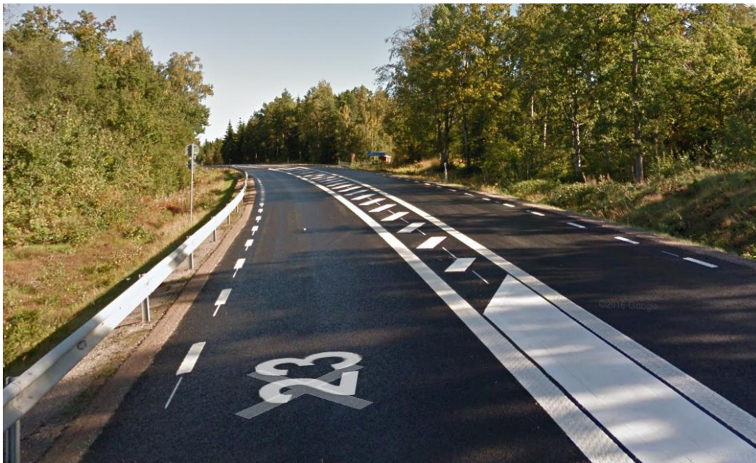
Figur 4. Otillräcklig horisontalradie förbi korsning med väg 693 mot Vederslöv medför kurvvrättning.
