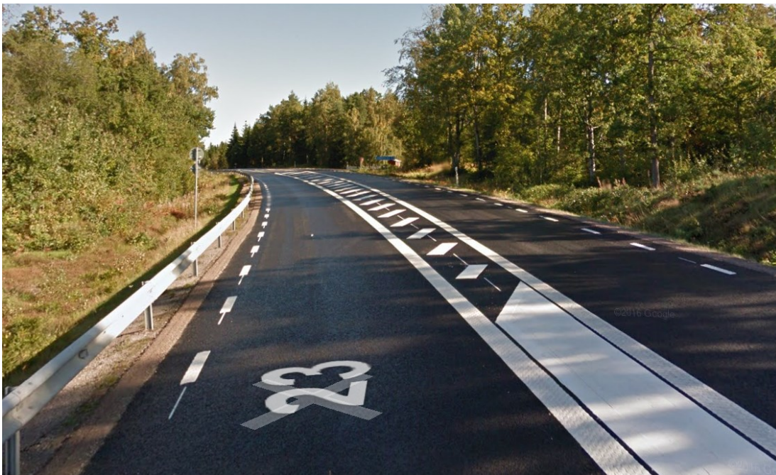
Figur 5. Otillräcklig horisontalradie förbi korsning med väg 693 mot Vederslöv medför kurvvrättning.
