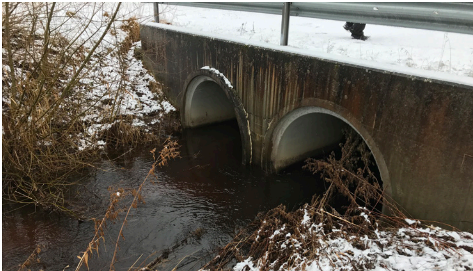
Figur 10 Befintlig dubbeltrumma strax väster om den nya planerade passagen över ån.
