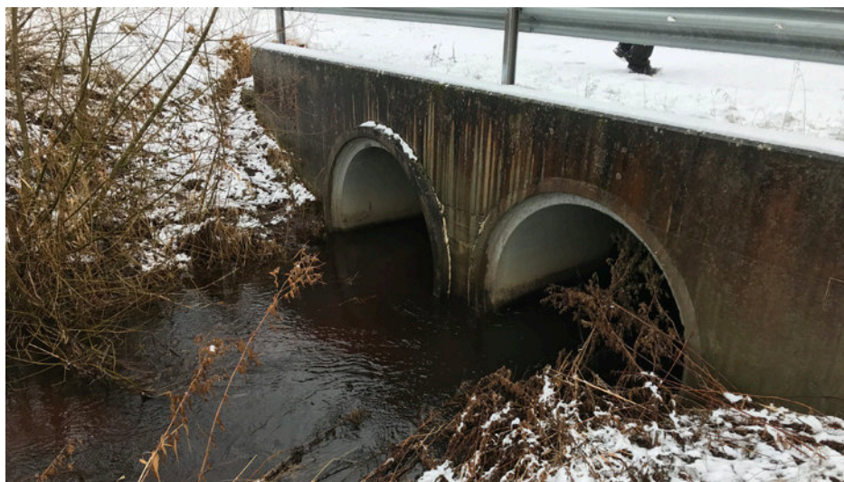
Figur 6. Exempel på utformning av trumma för Fjärlövsån. Bilden är tagen cirka 20 meter väst om den nya planerade passagen över ån. Dessa trummor har dock inte snedställda trumögon, vilket de nya trummorna föreslås ha.
