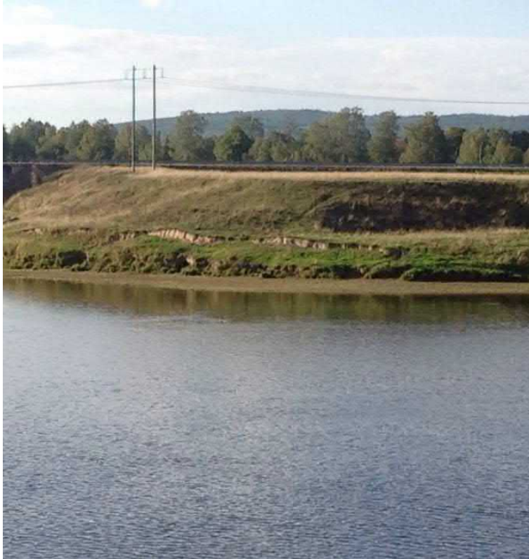
Figur 3. Exempelbild på skred från Näsgårdsön i Dalälven. Foto: Sweco.
